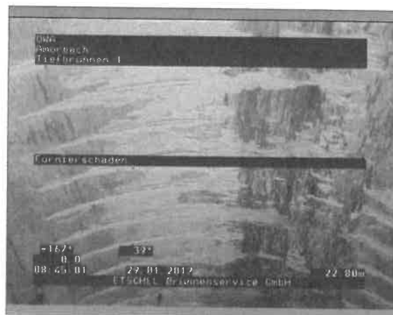
Foto: 1_1_14_29012019_084308_A.JPG 22,8m, Furnierschaden
