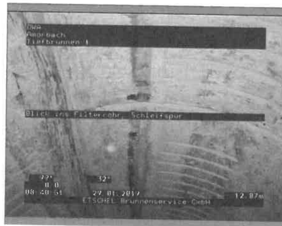
Foto: 1_1_12_29012019_083858_A.JPG 12,87m, Blick ins Filterrohr / Schleifspur
