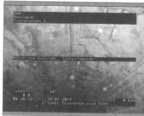
Foto: 1_1_5_29012019_082829_A.JPG 0,69m, Blick ins Vollrohr / Schleifspuren
