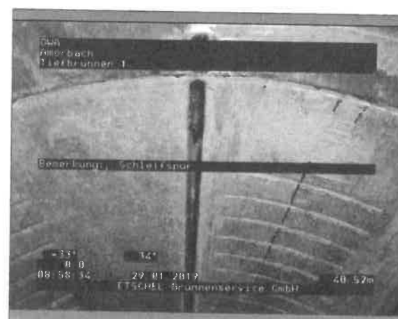
Foto: 1_1_22_29012019_085640_A.JPG 40,52m, Bemerkung: / Schleifspur
