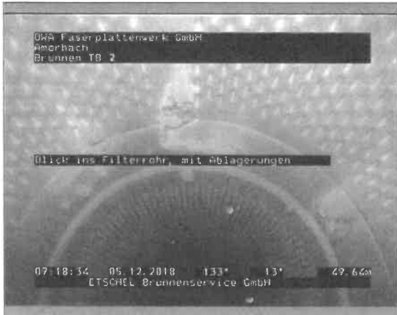
Foto: 1_1_19_A.JPG 49,64m, Blick ins Filterrohr / mit Ablagerungen
