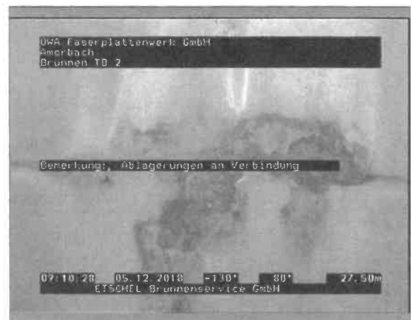
Foto: 1_1_12_A.JPG 27,50m, Bemerkung: / Ablagerungen an Verbindung
