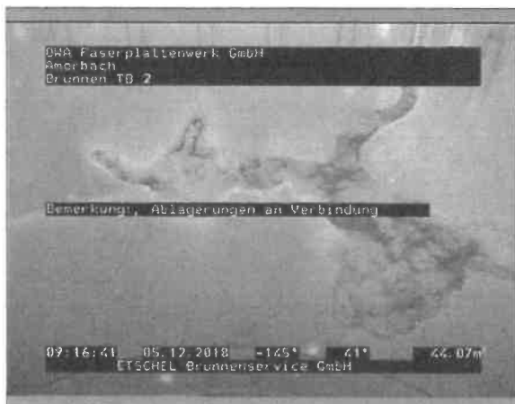
Foto: 1_1_17_A.JPG 44,07m, Bemerkung: / Ablagerungen an Verbindung
